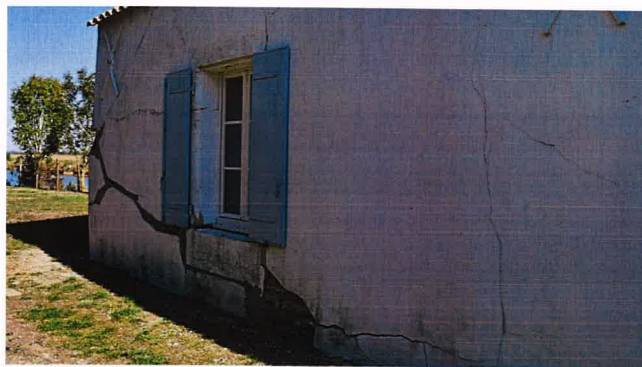
Les deux gîtes de pêche centenaires, patrimoine de la commune de Sainte-Radégonde-des-Noyers, sont eux aussi très endommagés par des fissures survenues à cause de la sécheresse. | PHOTO : OUEST-FRANCE
