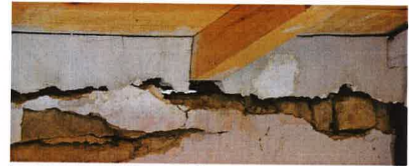
La sécheresse a causé d'importantes fissures dans la maison de Lionel et Nathalie Roux. À tel point que plusieurs endroits s'affaissent.
